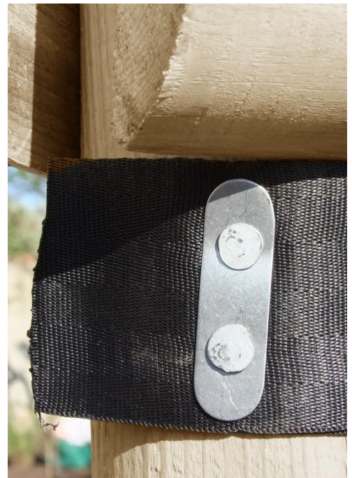
Abbildung 9: Bei Baumanbindung mit Gurten sollte auf eine angemessene Befestigung an den Pfählen geachtet werden, Bildquelle: LfULG
